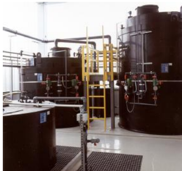
Neutralisation und Chemikalienlagerung / neutralization and storage tanks for chemicals
