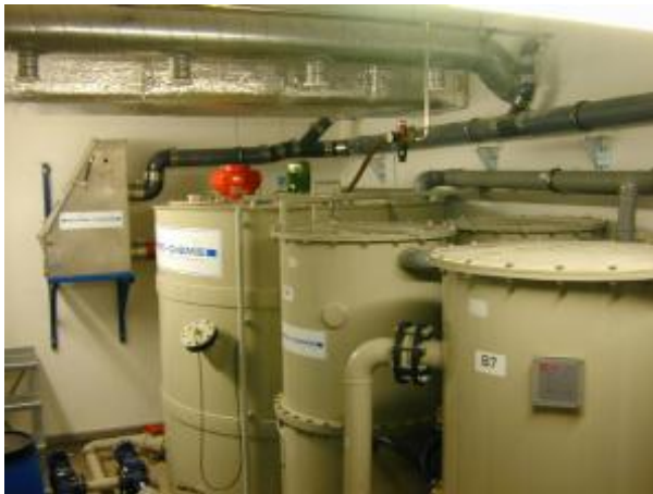
Split-O-Mat® FAT zur Aufbereitung fetthaltiger Küchenabwässer der Mensa der FH Wiesbaden
