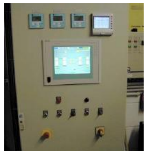
Schaltschrank der Anlage
