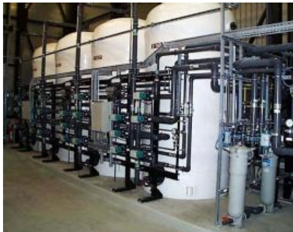
Molybdän-Ionenaustauscher, 30 m³/h Molybdenum Ion Exchanger, 30 m³/h
